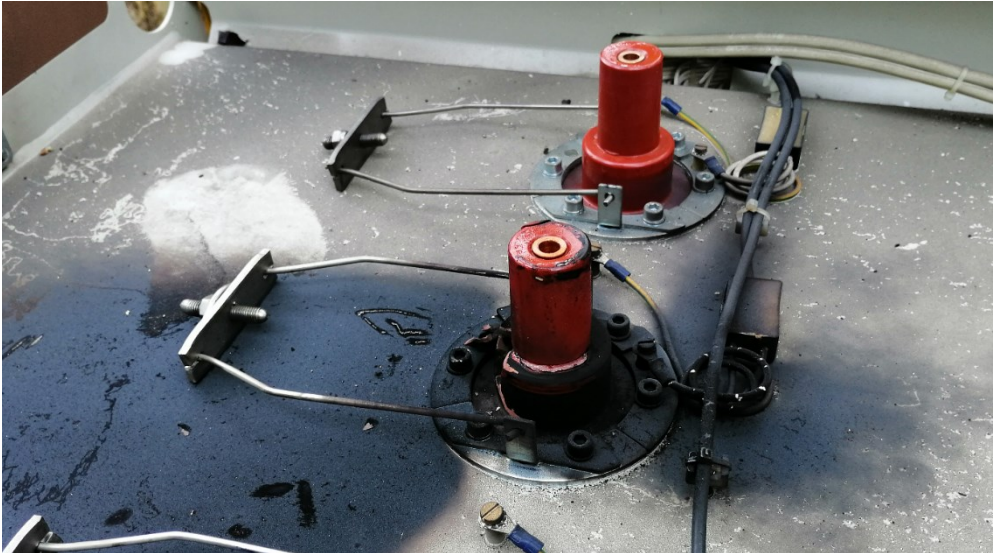
Slika 2. Proboj na provodnom izolatoru
